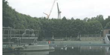
Station de traitement des eaux (Allemagne)
