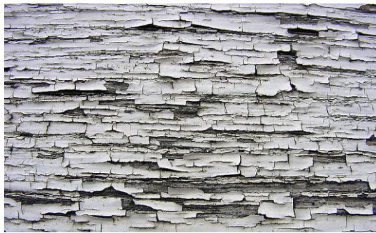
Figure 1 : Paroi peinte à la peinture au plomb
